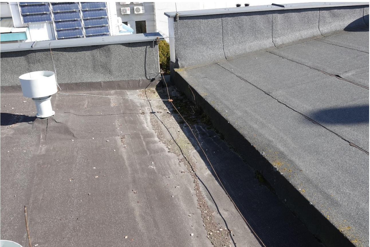
Fot. Koryto odwadniające
